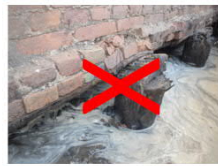
Funderingsschade (palen en op staal gefundeerd)
